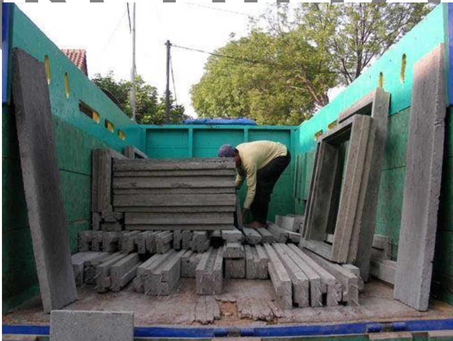
Gambar 13. Pengiriman komponen ke lokasi (Sumber : Proceeding ICBS dan Dokumentasi Bpk. Andry Widyowijatnoko)
